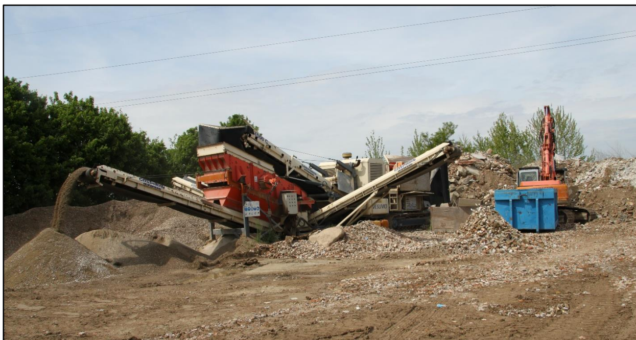
Figura 14: catena tecnologica, costituita da tritatore e vaglio, in lavorazione presso la sede dell'impianto
