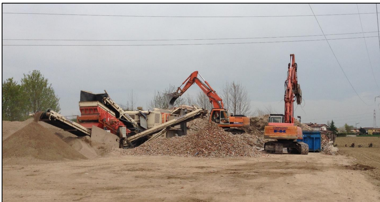
Figura 15: catena tecnologica, costituita da tritatore e vaglio, in lavorazione presso la sede dell'impianto
