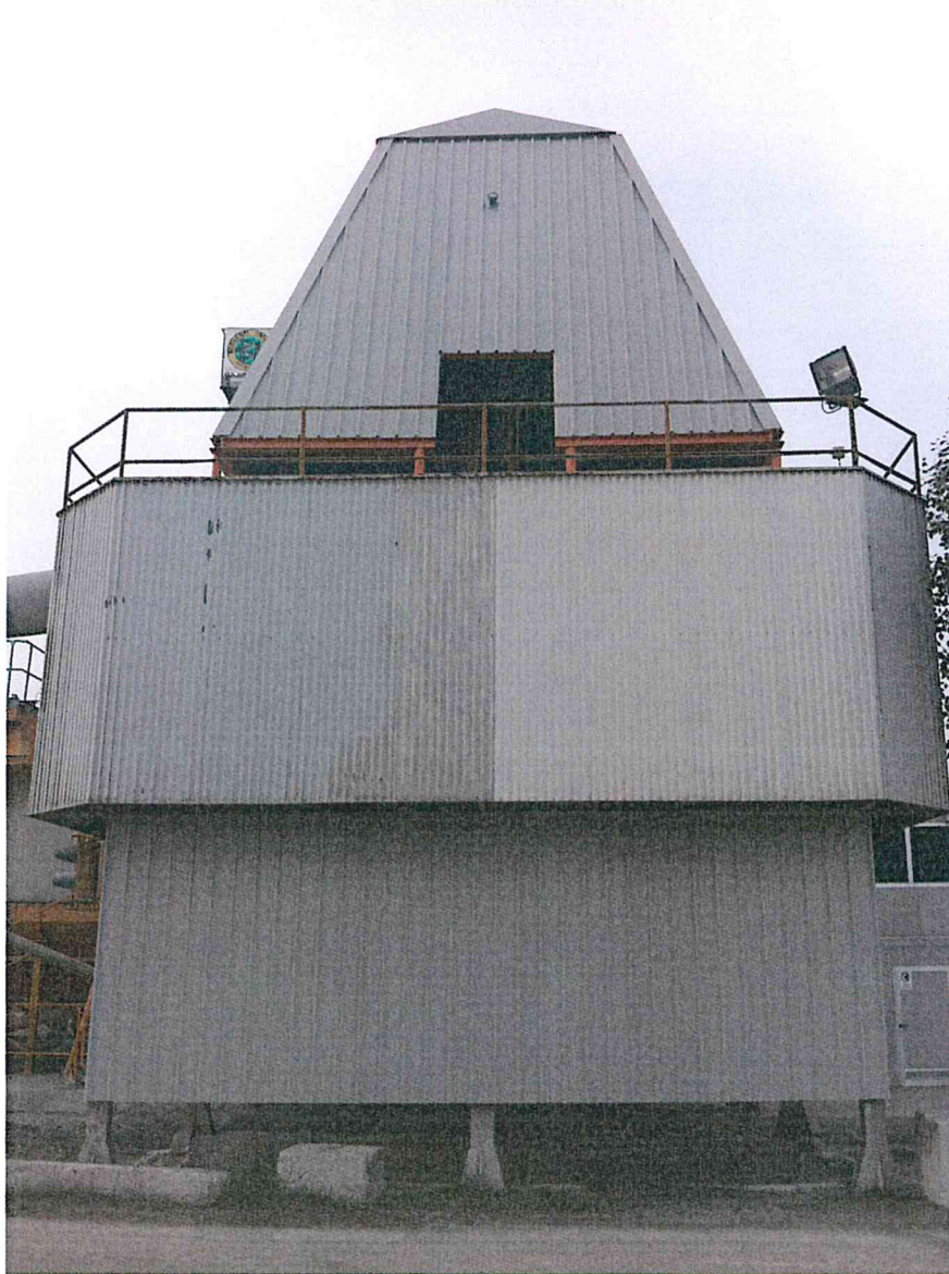
Particolare tunnel di scarico asfalti nei camion
